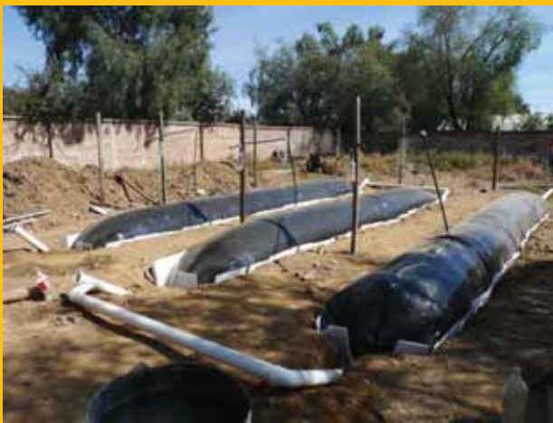
Biodigestores tubulares plásticos en serie (Matadero Municipal de Cochabamba, 2013)
